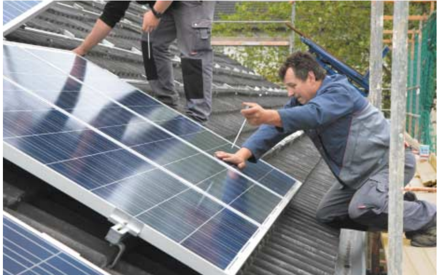
Hier ist Handarbeit gefragt: 2.631 Solarmodule werden in luftiger Höhe auf den Dächern der Pommernsiedlung in Gelsenkirchen-Bismarck montiert. Foto: THS.
